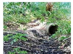
Der Ableiter des kleinen Teiches in Walda soll saniert werden. Doch ein Grundstückseigentümer sperrt sich. Foto: Anne Hübschmann
