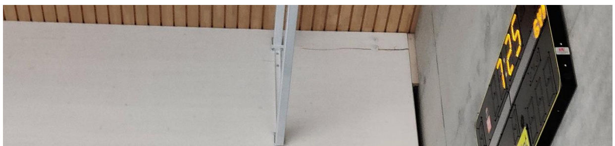
(Aufnahme vom 18.03.2021 – Riss im Dachbalken – Bild rechte Seite oben – JK)
